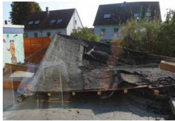
Das war mal ein Dach
